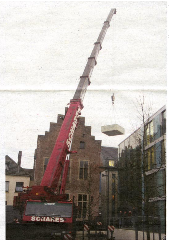
Mit einem Autokran ist das Fundament für das Kunstwerk am Gocher Rathaus gesetzt.
